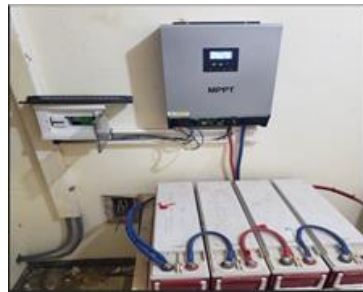
Fig.8.6. Pose onduleur hybride coffret et batteries
